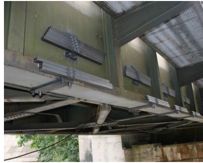
Absorbeur sur platelage
